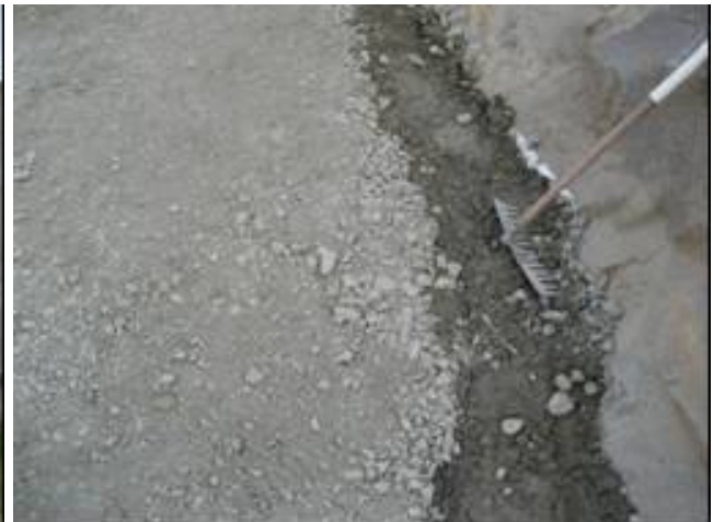
Presas donde no se dio atención adecuada a la compactación de los concretos CVC y CCR
