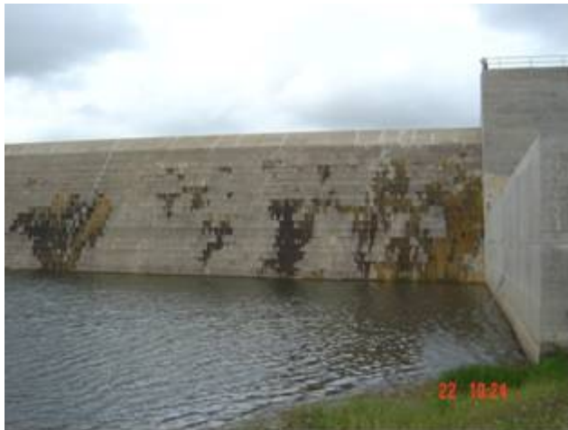
Presas donde no se dio atención adecuada al Sistema de Impermeabilización del Paramento de Aguas Arriba y al tratamiento de Juntas de Construcción
