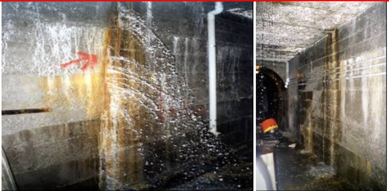
Presas donde no se dio atención (o se dio atención de forma errada) al Tratamiento de las Juntas de Construcción
