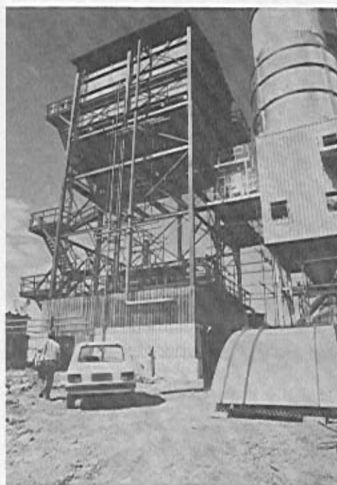
Figura 66 – Estrutura Metálica para Fábrica de Gelo. Na parte Superior a sala das Máquinas e Depósito de Gelo. Ao nível do Terreno a Sala dos Compressores, condensadores. Os resfriadores de Água estão no Nível Intermediário. U.N. Angra III.
