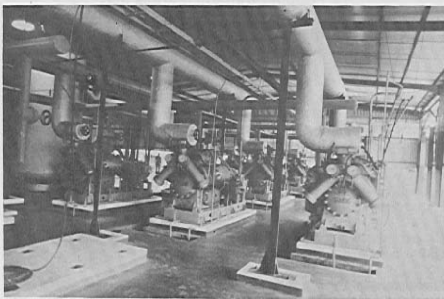
Figura 56 – Compressores Multicilindro – em funcionamento – na Sala de Compressores – UHE – Tucuruí
