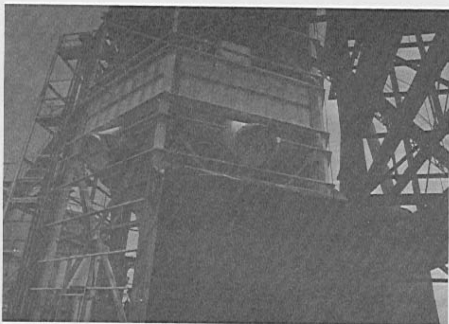
Figura 39 – Entradas de ar frio para silos da Central e Sistema de Controle com as Válvulas Borboletas – UHE- Três Irmãos.
