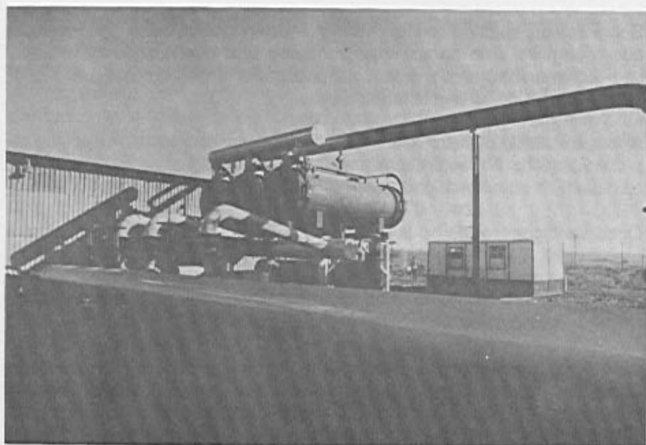
Figura 60 – Vazos Condensadores tipo Shell and Tube – UHE – Três Irmãos
