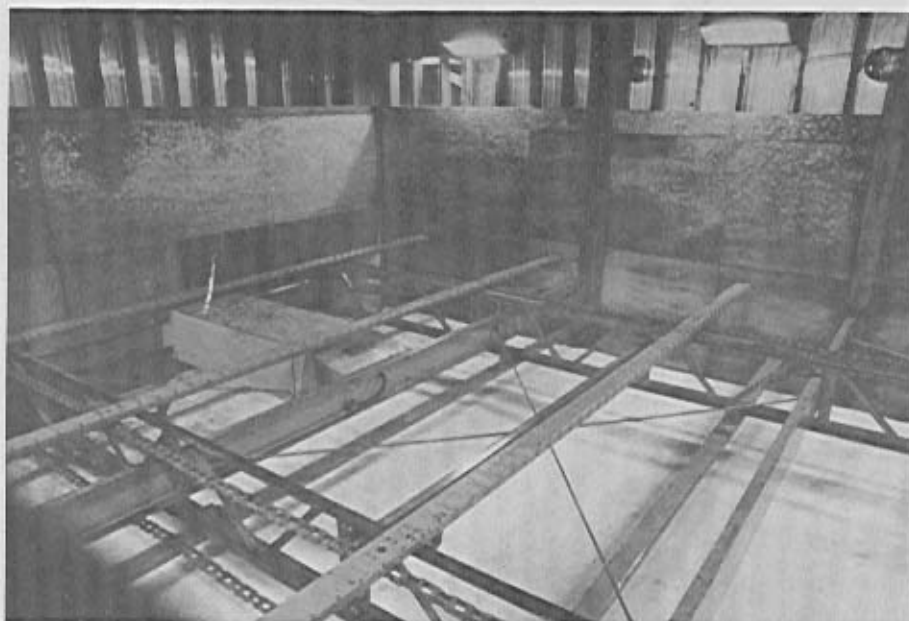
Figura 47 – Raspador ("Rake") do Silo de Gelo – UHE – Porto Primavera.
