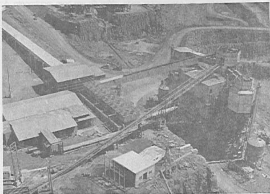
Figura 54 – Instalações de Refrigeração de Concreto, na Margem Esquerda – Canteiro de Obras de Itaipu
