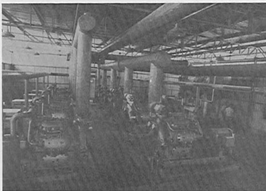
Figura 63 – Vista Geral da Sala dos Compressores – UHE Itaparica
