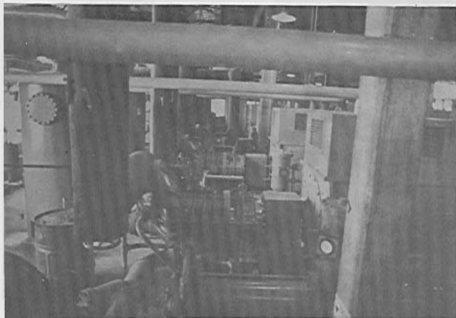
Figura 57 – Compressores Tipo Parafuso – UHE – Itaipu
