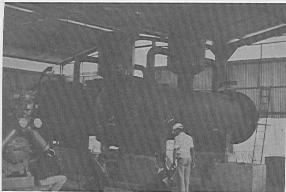
Figura 32 – Resfriador de água, multitubular tipo "Shell and Tube" – UHE – Porto Primavera
