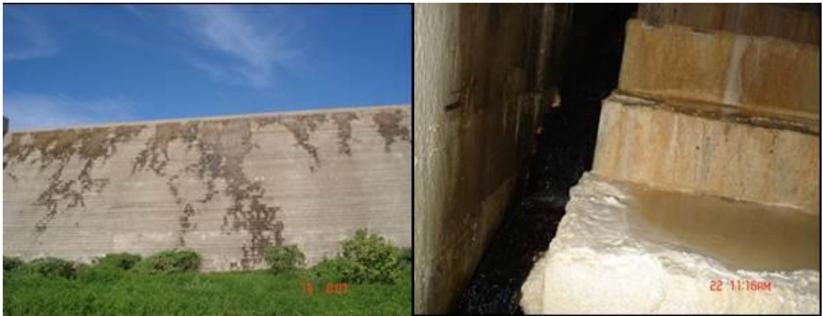
FIGURAS 4 – Vistas de uma outra Barragem, e uma galeria no seu interior, terminada ao redor de 2000, no Brasil, evidenciando pouca Qualidade.
