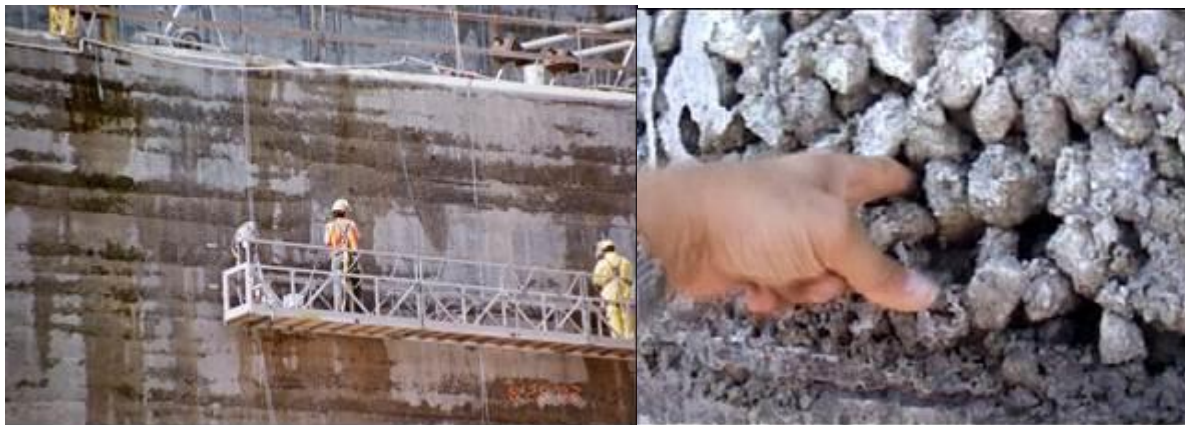
FIGURAS 7 – Bicheiras no Grout Enriched RCC, da face da Barragem de Olivenhain.
