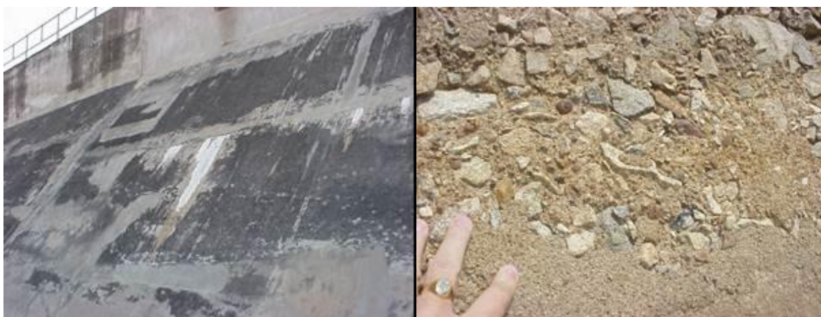
FIGURAS 3 – Vistas de uma Barragem, terminada em 1987, no Brasil, evidenciando pouca Qualidade e Durabilidade limitada.
